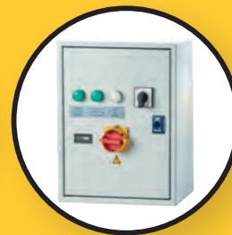
Externer Schaltkasten mit Stern-dreieck-Schaltung
